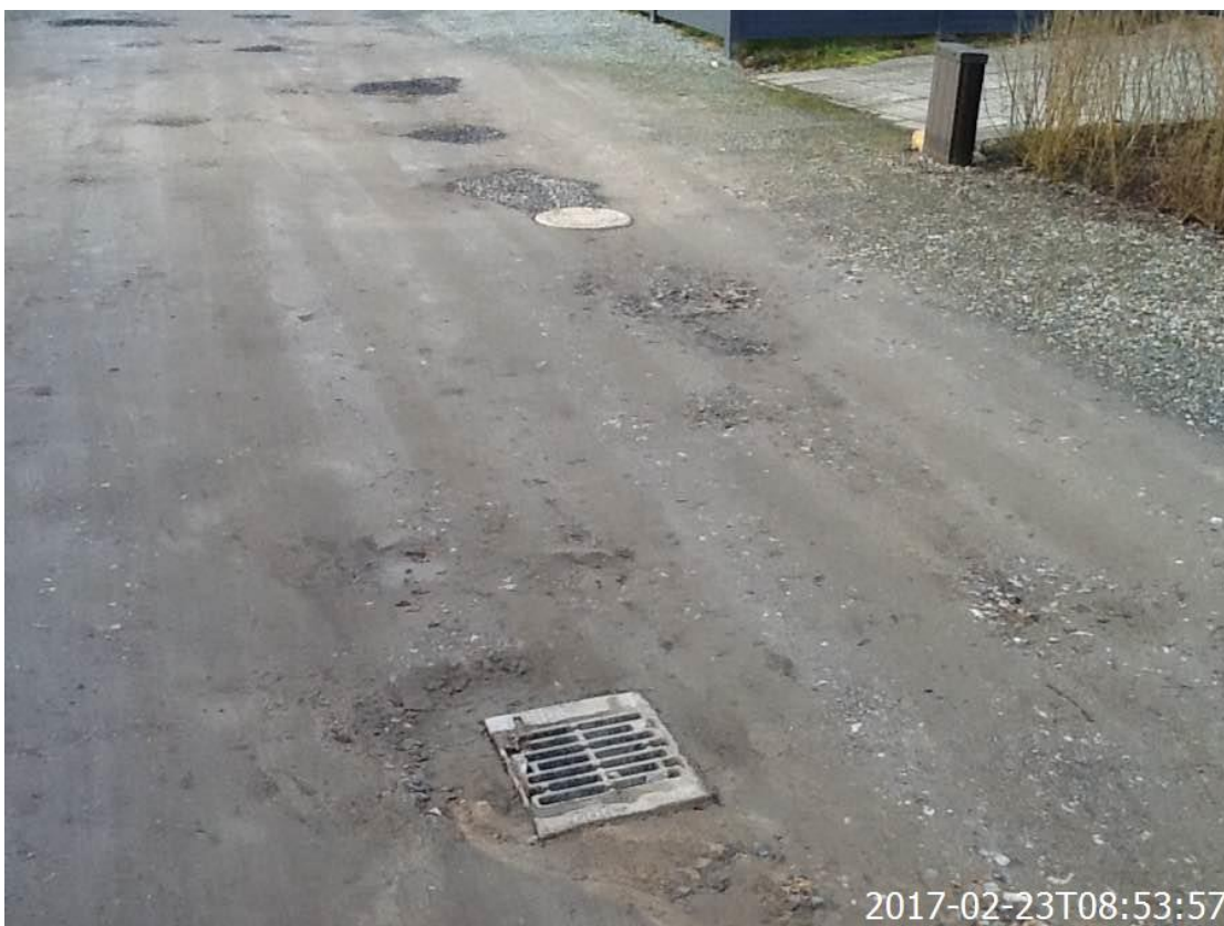
Rist på nedløbsbrønd og brønd efter udførelse af nedsivningsanlæg. Til fiksering af dæksel og rist udføres der asfaltering på 1 x 1 m. omkring rist og dæksel.
