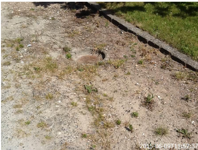
Røllikevej rist i rabat ved nr. 30 inden udskiftning
